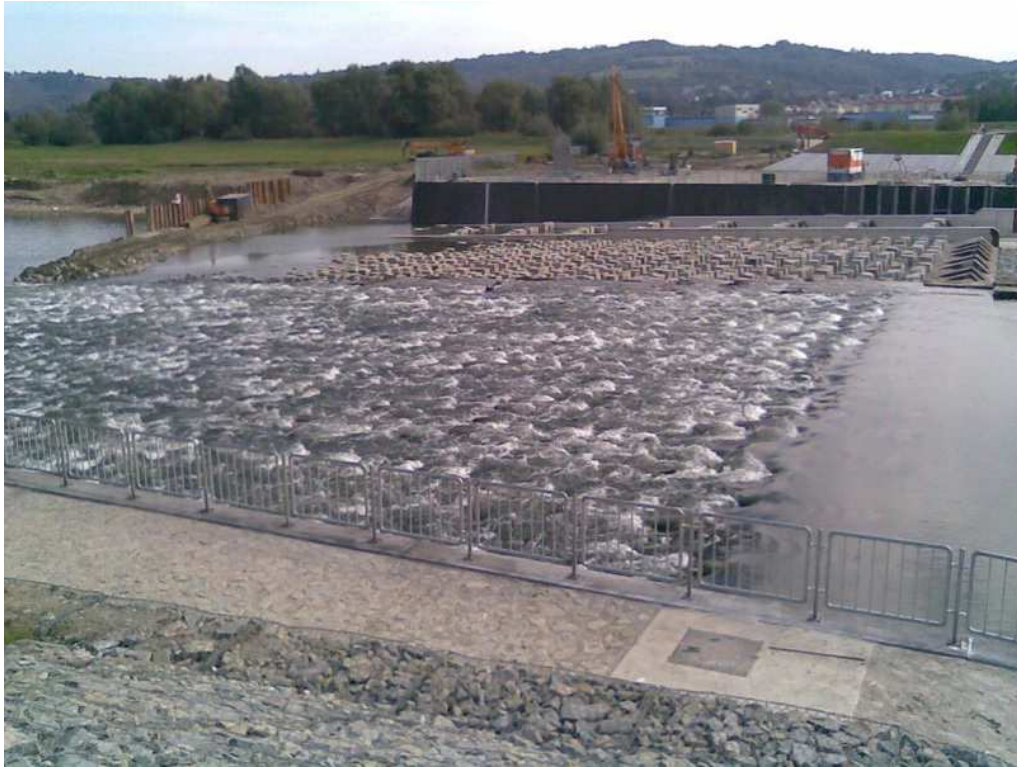
Fot. 3. Przepławka w formie bystrotoku na Sanie w Przemyślu, otwarta w 2015 r. Źródło: fot. B. Antoniewski
