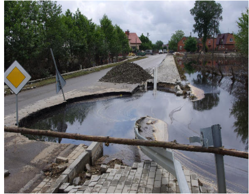
Fot. 3. Entropia (droga uszkodzona przez wody powodziowe na osiedlu Sokolniki w Tarnobrzegu, maj 2010) Źródło: Zbiory autora
