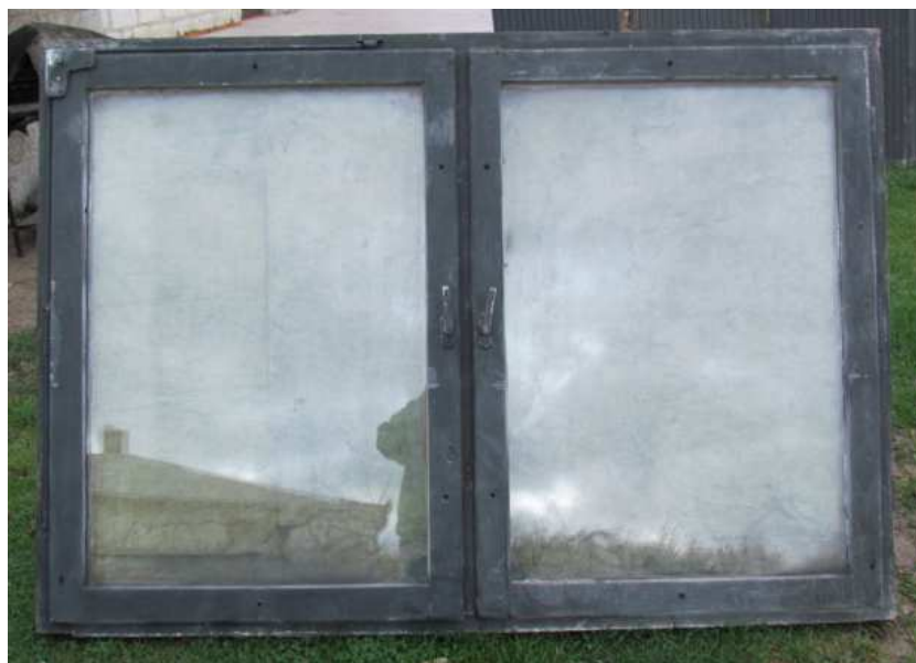
Fot. 2. Rama z okna drewnianego
