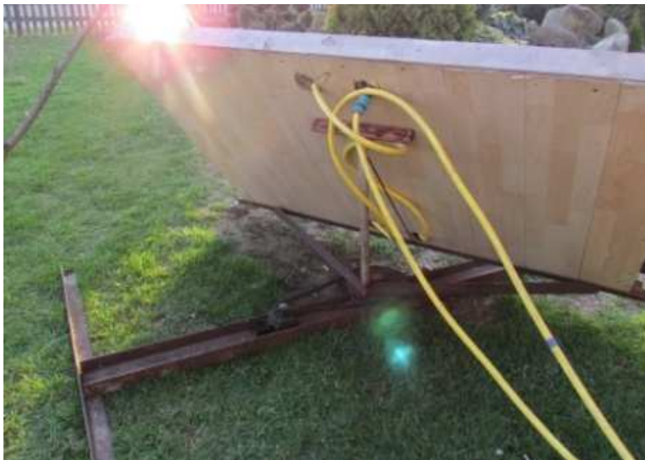
Fot. 6. Przewody przesyłowe łączące kolektor z całością instalacji Źródło: fot. M. Dyląg
